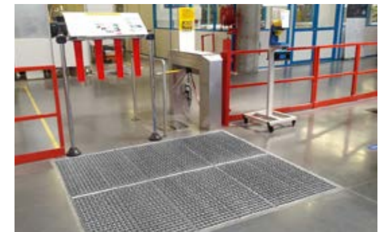
Sohlen- und Rollenreinigung durch ProfilGate® st55 go vor ESD-Bereich
